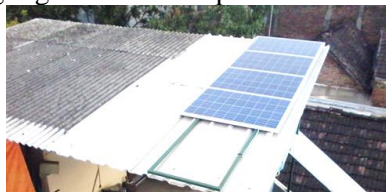
GAMBAR 7 SOLAR CELL YANG TERPASANG
